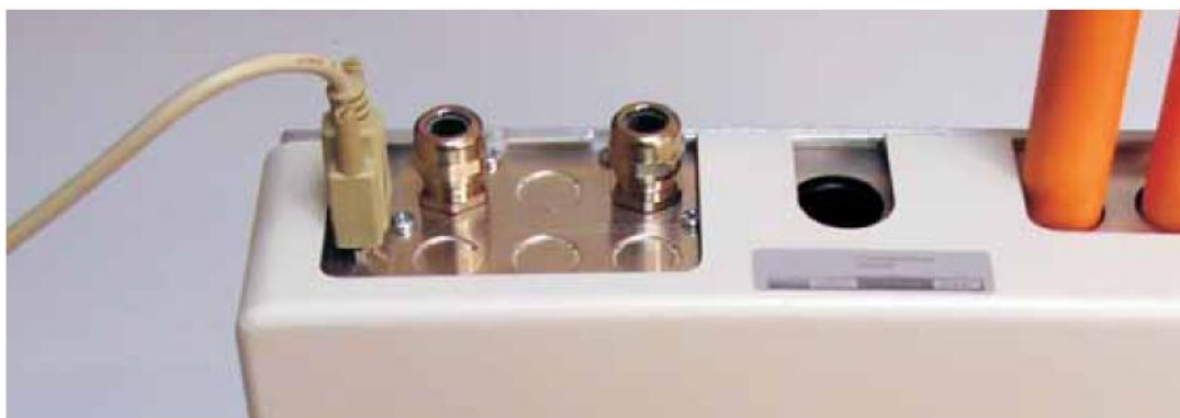
Figura 26: Conexión de un PC al puerto RS-232 del módulo de comandos
